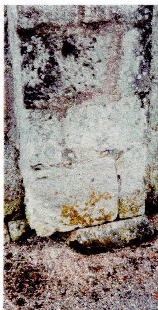
Base du contrefort Nord cassée
