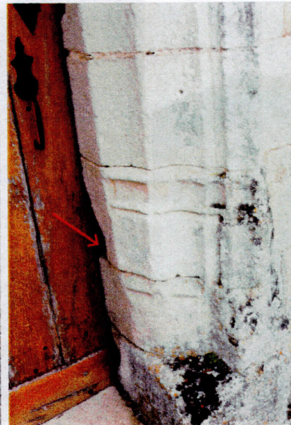
Base Sud du portail Sud, pierre cassée, joints dégarnis
