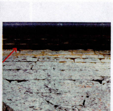
Détail génoise et gouttière, fixation à pic à revoir
