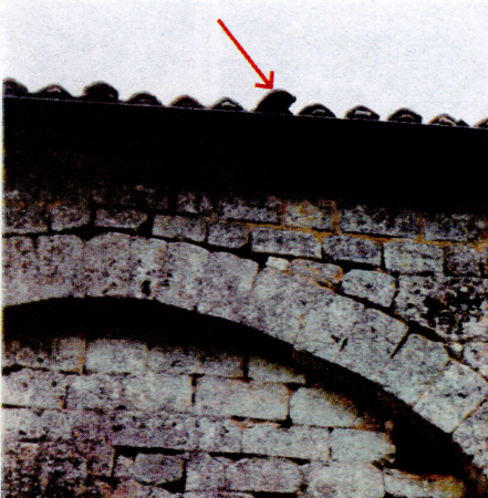
Déjointement important, tuile d'égout détachée
