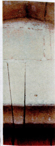
Claveau du portail Sud déchaussé
