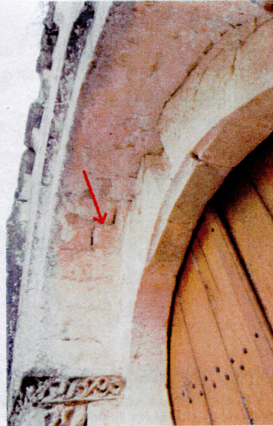
Détail de l'arc du portail Nord, fissure
