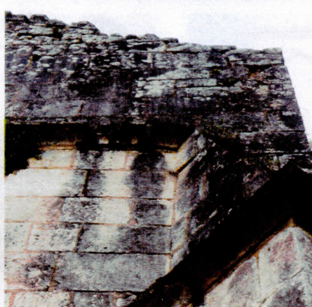
Angle Sud du pignon, corniche et glacis dégradés avec végétation
