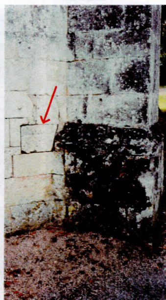
Contrefort angle Sud, vue Ouest : joints manquants
