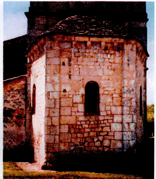
Chevet, joints ciment ou manquants, mousse sur les lauzes, Villeneuve ACMH
